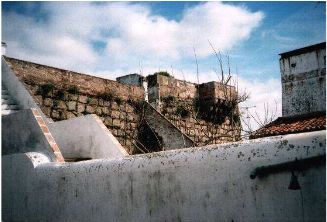
Figura 17 - Troço de muralha e balcão (258/664), Nossa Senhora da Graça (Fotografia de Sr. João Francisco Lopes)
