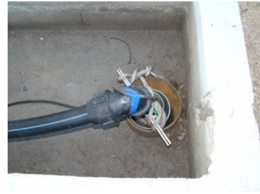
Fig.2c. Boca do furo encontrava-se a descoberto
