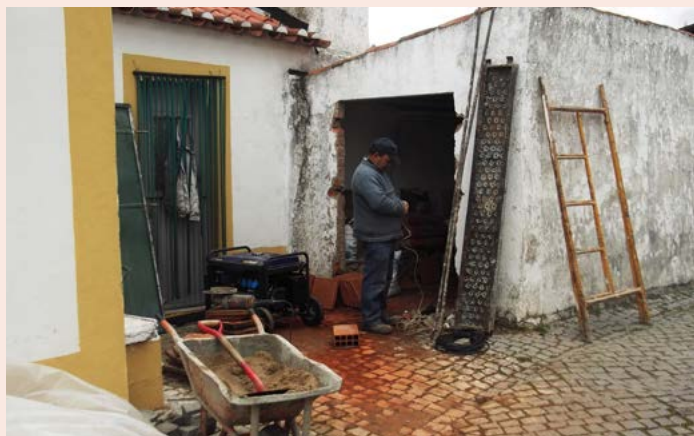
SANTANA Obras de Conservação e Restauro do Forno Comunitário do Monte do Pardo
