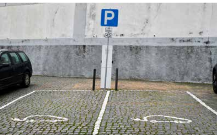
NISA Posto de abastecimento de veículos elétricos
